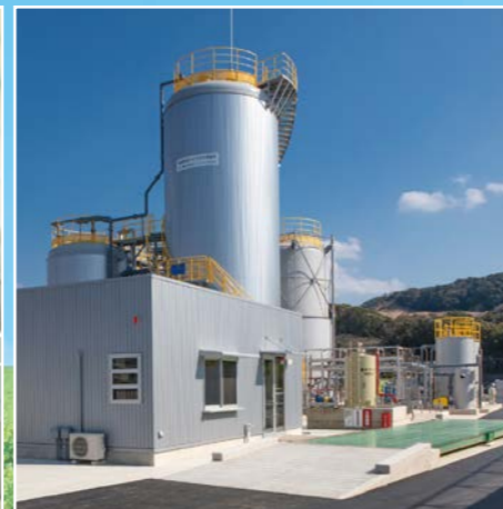
水処理設備(嫌気性排水処理設備)
