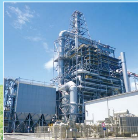
バイオマス発電プラント(サミット半田/パワー(株)納入)
