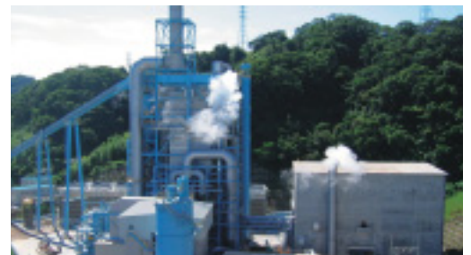
土佐発電(株)167MW発電設備
