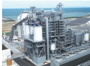
CFBボイラ 発電プラント
