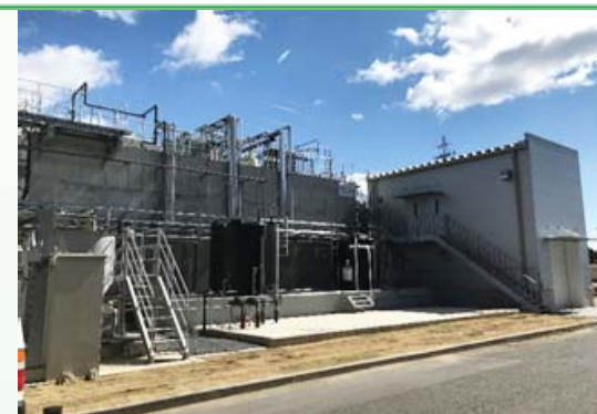
排水処理場増設設備
