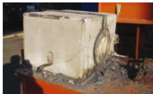
図9 充填コンクリートのひび割れ状況 Condition of specimen at final stage of loading
