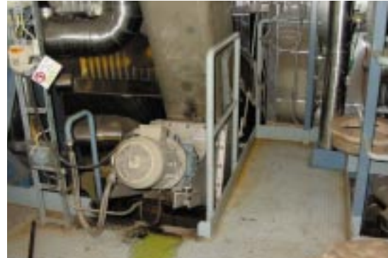
図8 バイオマス供給フィーダ Biomass feeder
