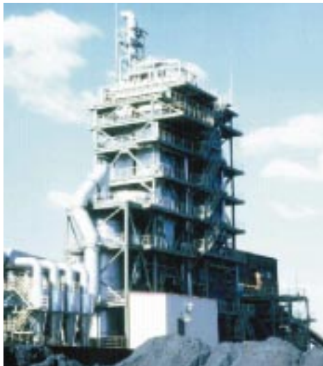
図1 ガスト溶融還元施設（住友金属工業株式会社） Dust reduction system
