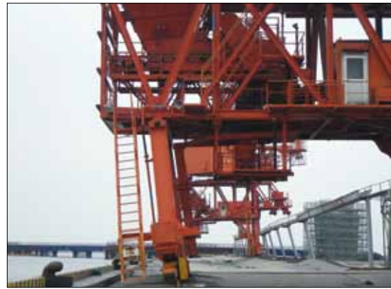
図3 脱輪, 傾斜, レール湾曲 Derailment, inclination bending of a rail
