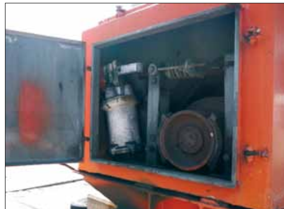
図5 ブレーキ破損 Broken brake
