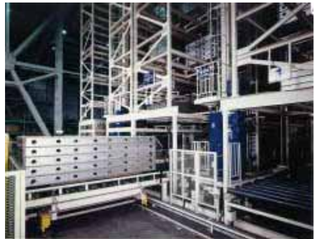
図3 長尺用自動倉庫 ASRS for long item
