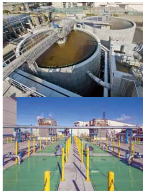
〈住友重機械エンバイロメント株式会社〉
